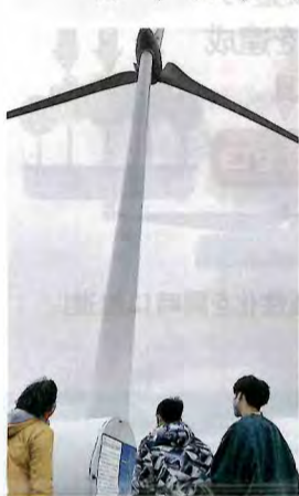
苫前町にある風力発電施設
