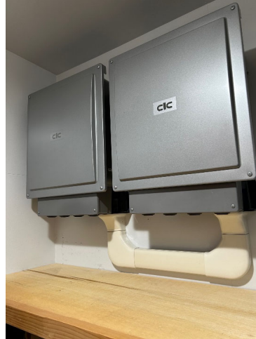
写真 蓄電池パワコン
