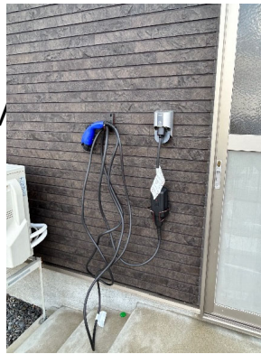
写真 充電コンセント
