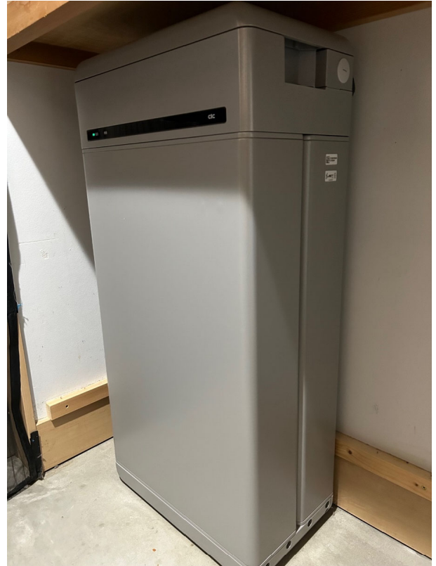
写真 蓄電設備
