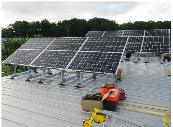
写真 屋根上の太陽光パネル
