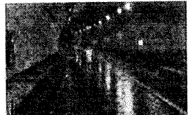
トンネル内の凍結
