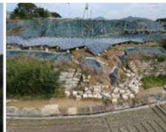
法面保護工が崩れて流出した事例
